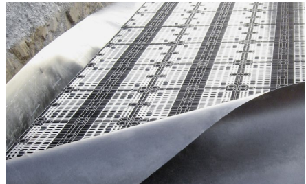
Bassin de rétention avec géomembrane
